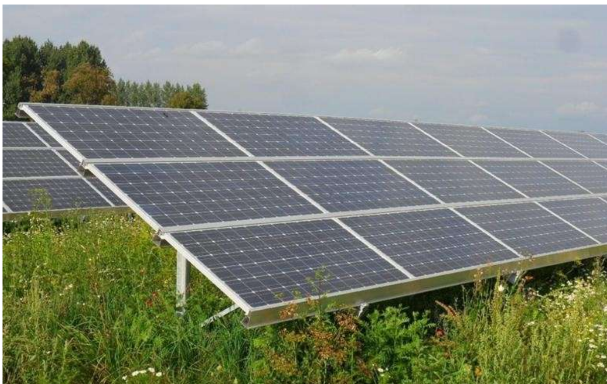
Fot. 24. Przykładowe zagospodarowanie terenu pod oraz pomiędzy rzędami stołów fotowoltaicznych.
