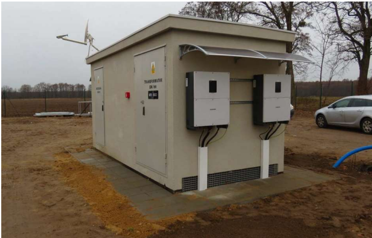
Rysunek 8. Przykładowa stacja transformatorowa z zainstalowanymi inwerterami
