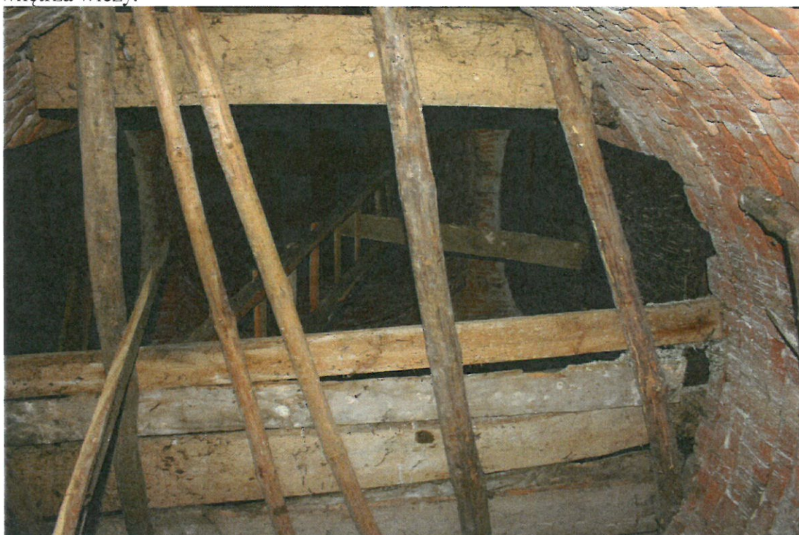
Fot.8 Brak dostępu od wewnątrz budynku do stolarki okiennej.
