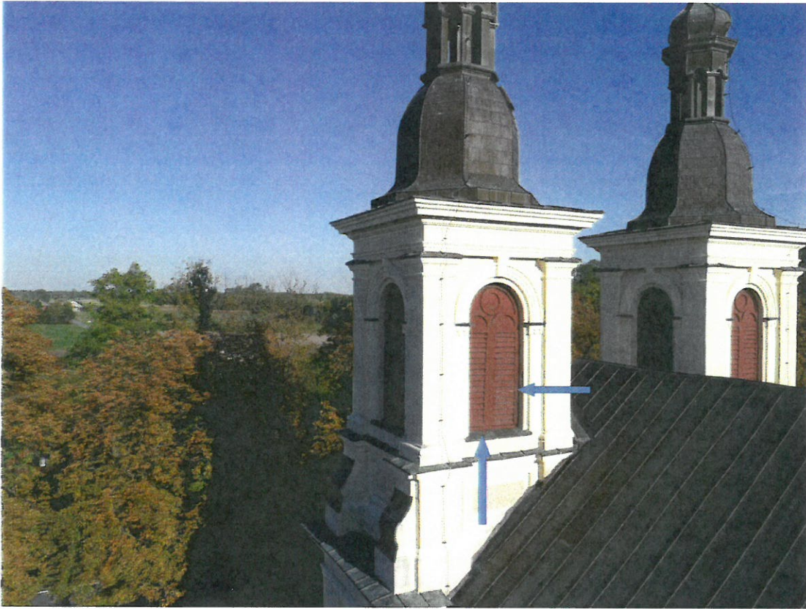
Fot. 1 Wieża południowo-zachodnia. Widoczne wypaczenie konstrukcji żaluzji od strony wschodniej.
