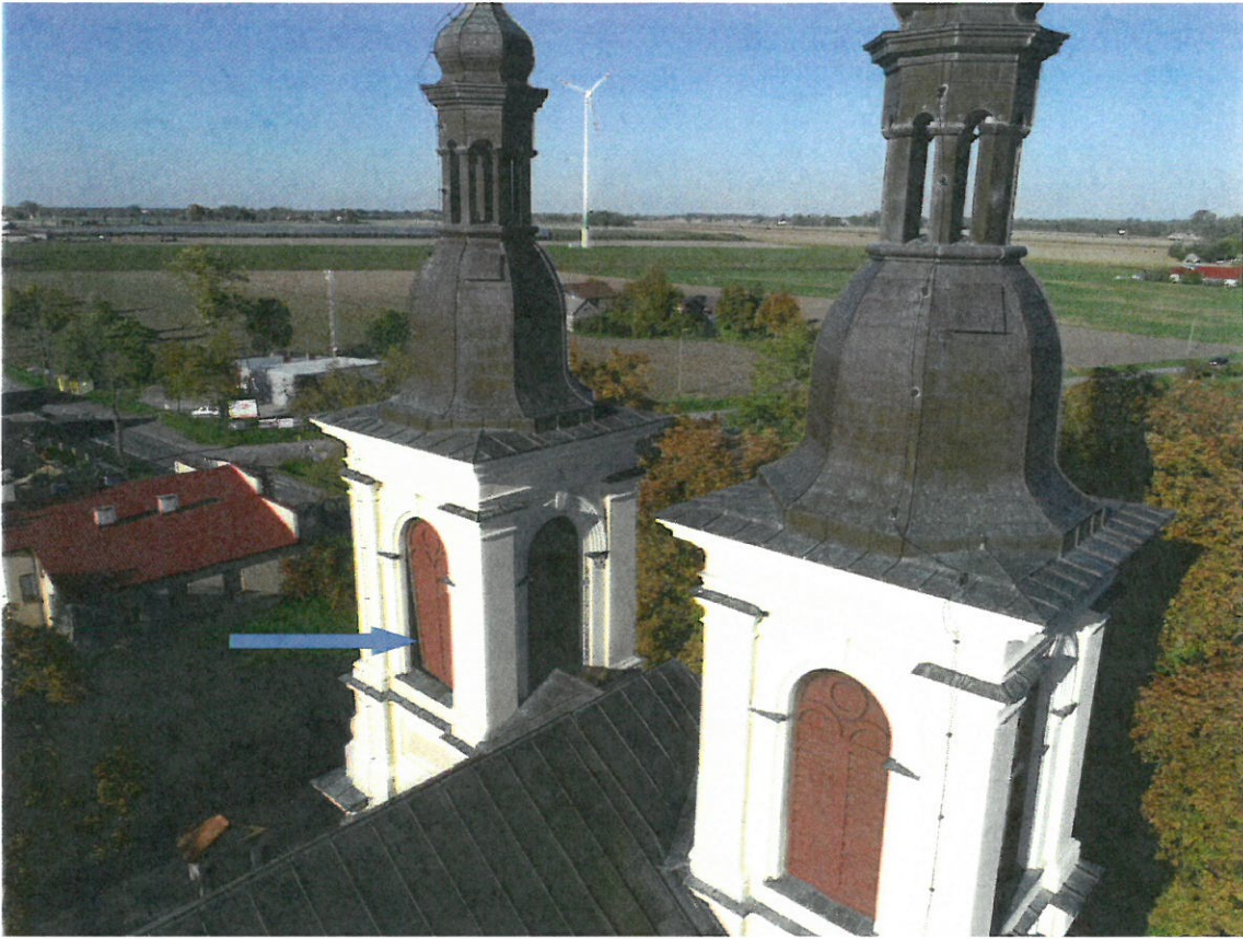
Fot. 4 Widoczne wypaczenie konstrukcji żaluzji w wieży południowo-zachodniej. Wschodnia żaluzja.
